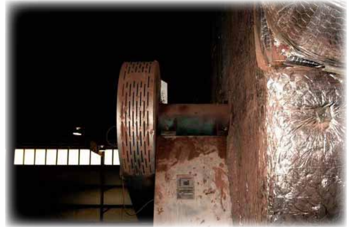
Hot air exhaust fan
